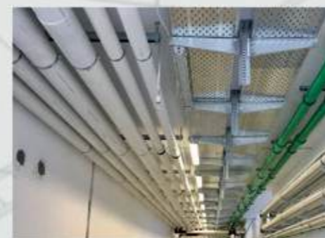
Rohre Aqua-Plus und Aqua-Plus Prins Prins in einem 5* Hotelkomplex
