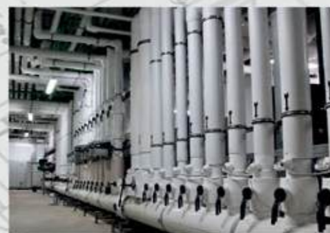
Vorisierte Verteiler und Rohrleitungen Aqua-Plus Prins in einem 5* Hotelkomplex
